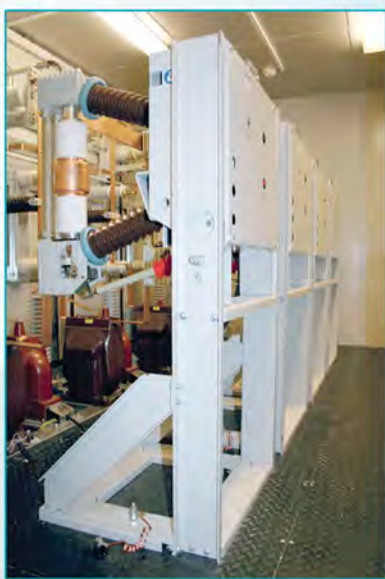
Высоковольтный отсек поста секционирования переменного тока ПС-25-2
