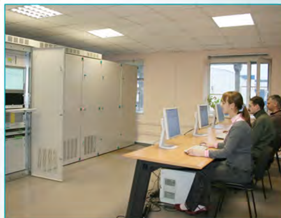
Лаборатория АСУ ТП для отработки технических и программных решений и обучения обслуживающего персонала (НИИЭФА-ЭНЕРГО)
