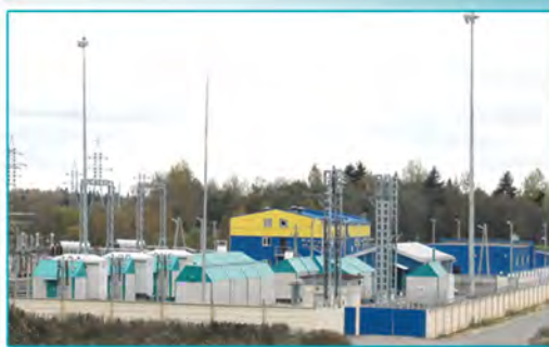
Тяговая подстанция постоянного тока "Веймарн" (Октябрьская железная дорога)
