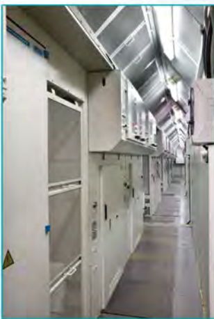
Функциональные блоки распределительного устройства 2х25 кВ Одностороннее обслуживание. Выполнены на базе шкафов серии "1С-2х25" или аналогичных. Ток главных цепей ячеек блока до 2000 А. Количество шкафов в блоке – до 3 шт.
