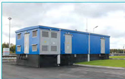
БКТПБ на станции Лужская – Сортировочная
