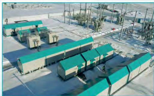
Подстанция 110/27,5/10/3,3 для Энгельского локомотивного завода
