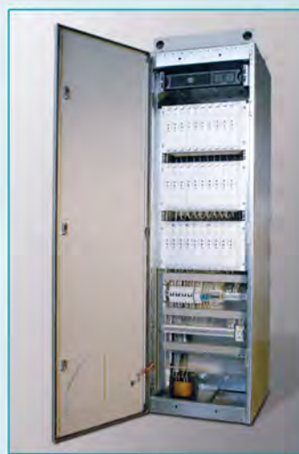
Шкаф управления разъединителями
