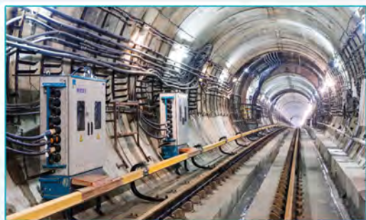
Оборудование тяговой сети 825 В на перегоне Достоевская – Марьяна роща Московского метрополитена
