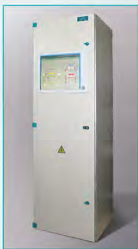
Шкаф управления подстанций
