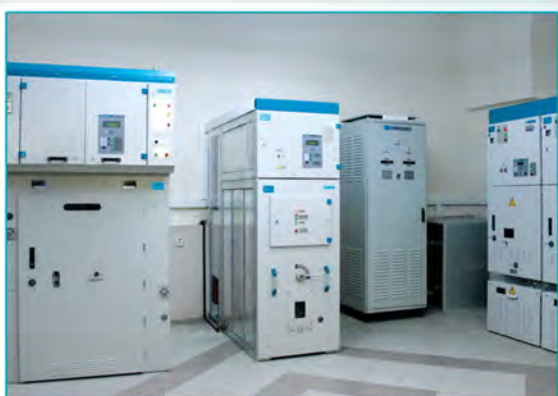
Учебная тяговая подстанция в ПГУПС (Санкт-Петербург)
