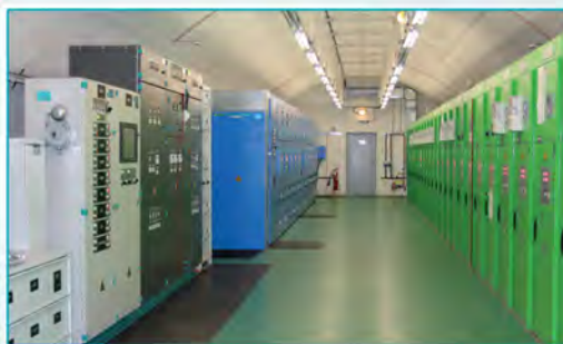
Машинный зал на станции метрополитена "Международная" (Санкт-Петербург)
