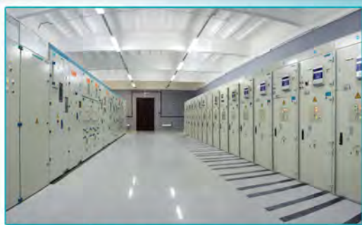
Машинный зал тяговой подстанции постоянного тока "Лейпсау" (Октябрьская железная дорога)
